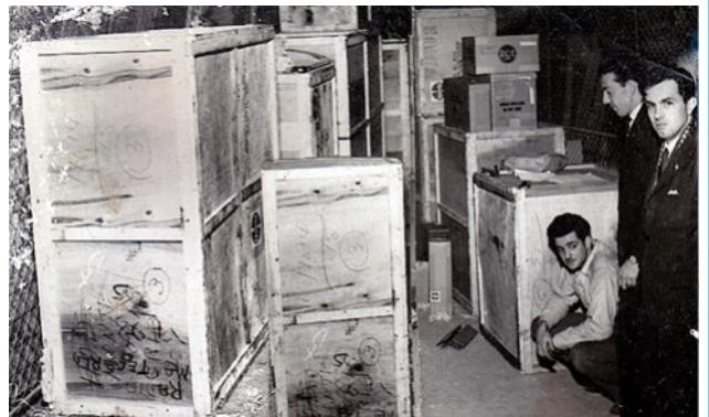
Instalación de los equipos de transmisión de Canal 4 Monte Carlo TV de Montevideo. A la derecha los técnicos que trabajaron en el montaje. Se ve, de pie mirando a la cámara, a un joven José Luis Ferreira, CX3BE.
